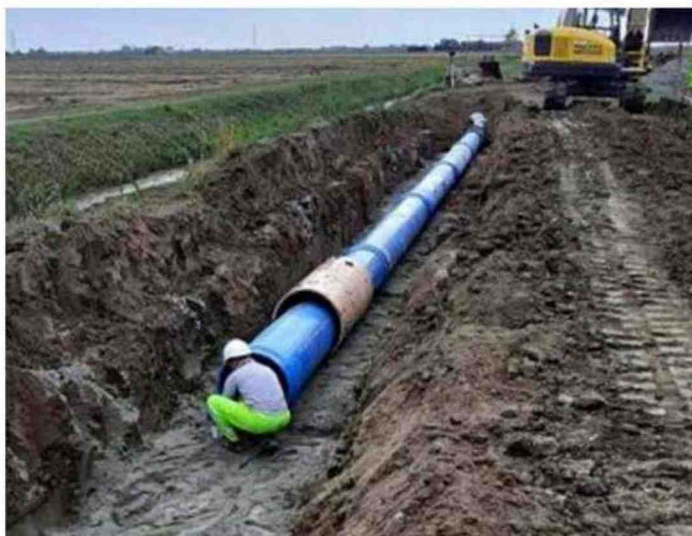
E' terminata la posa di nuova tubazione idrica metta in atto dalla società Cadf
