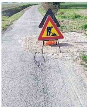
La buca sistemata dal Consorzio di Bonifica in via San Venanzio nei pressi della chiesa romanica
