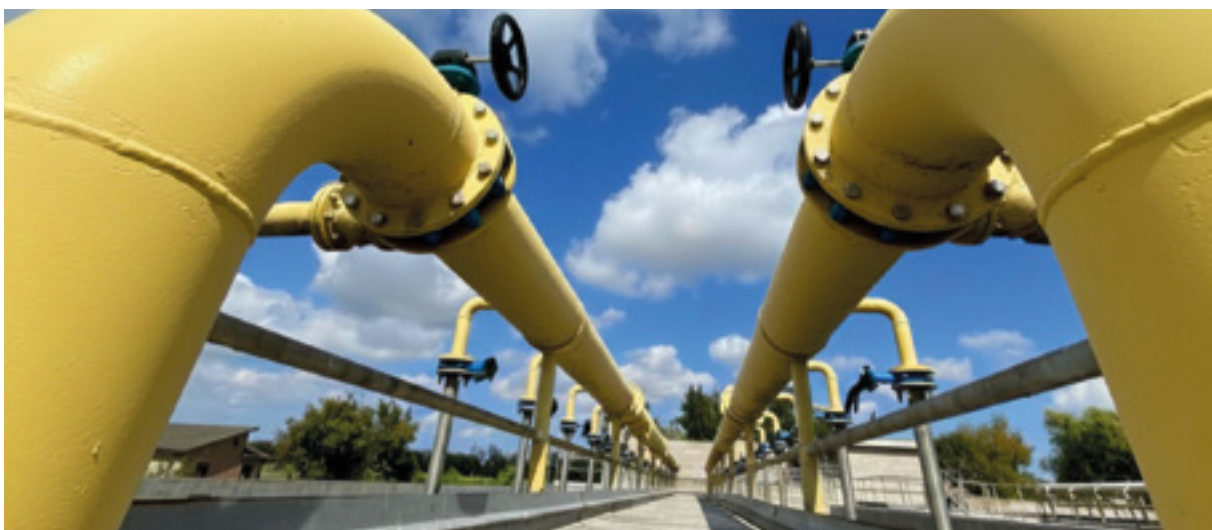
Vasche di aerazione - Centrale di potabilizzazione di Ro.
