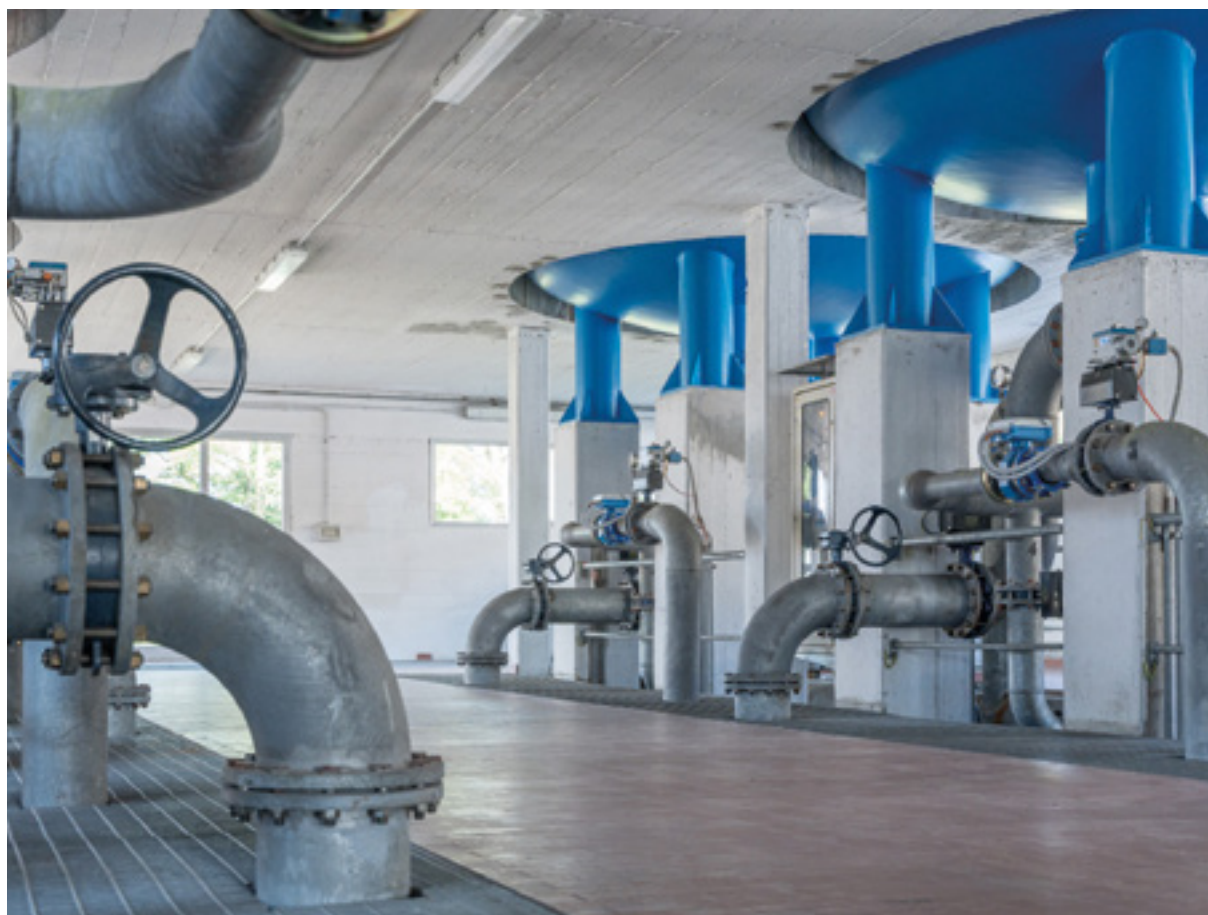
Interno area filtri - Centrale di potabilizzazione di Ro.
