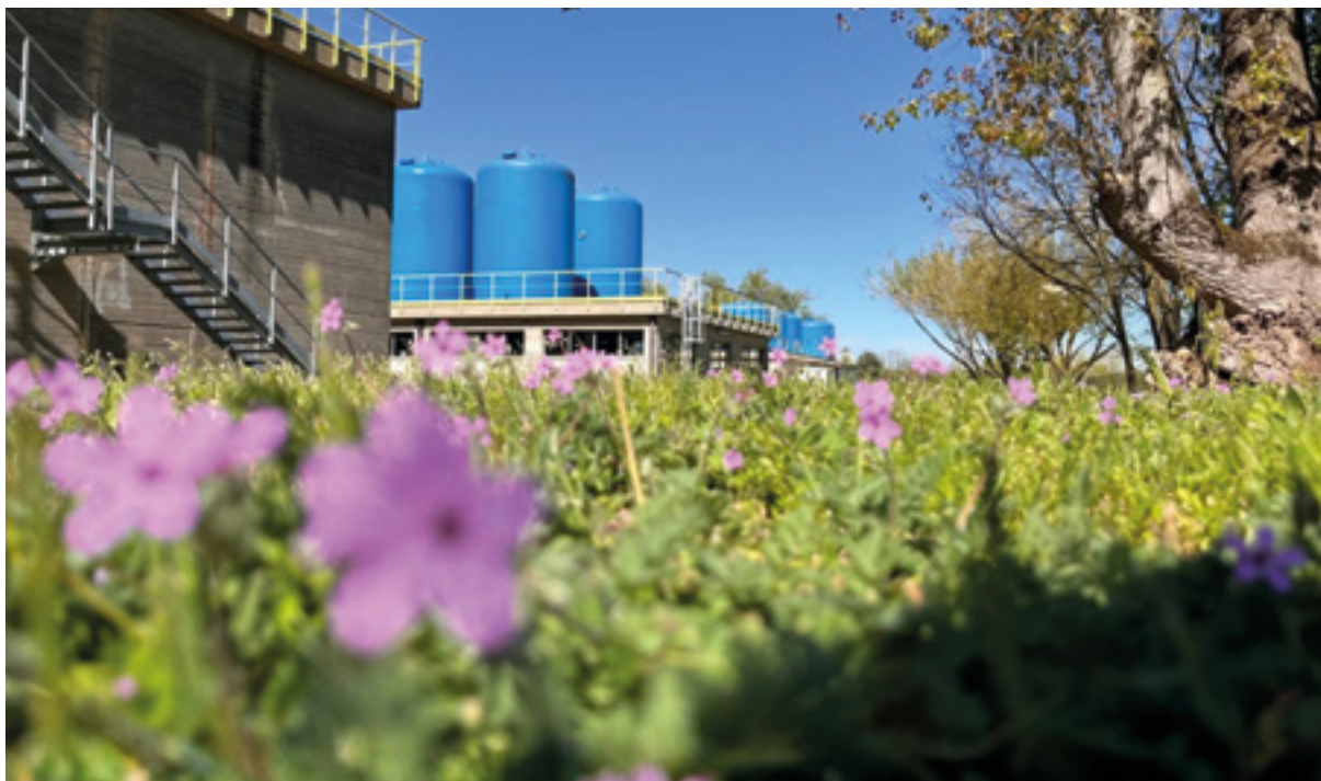
Vasca di accumulo e filtri - Centrale di potabilizzazione di Ro.
