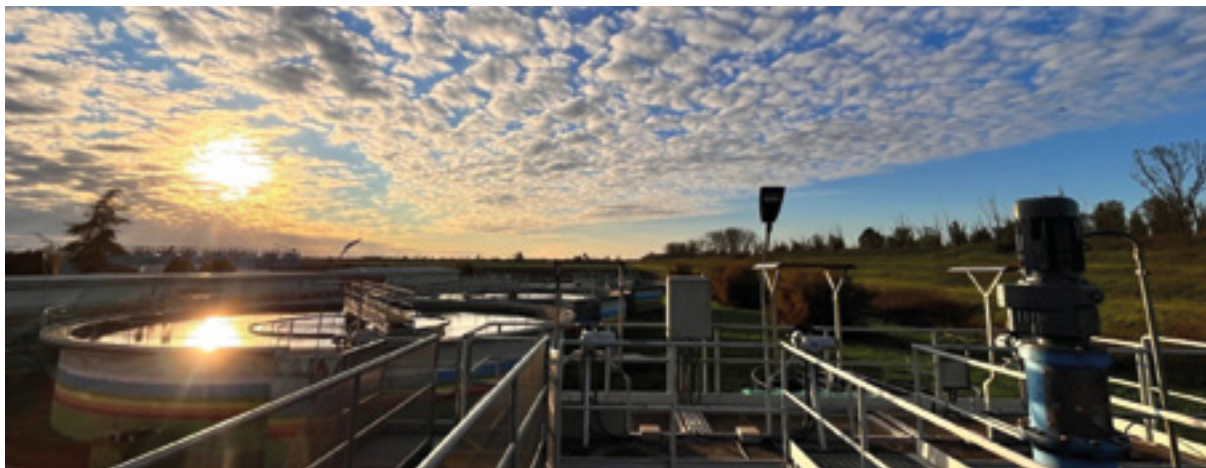
Centrale di potabilizzazione di Serravalle.
