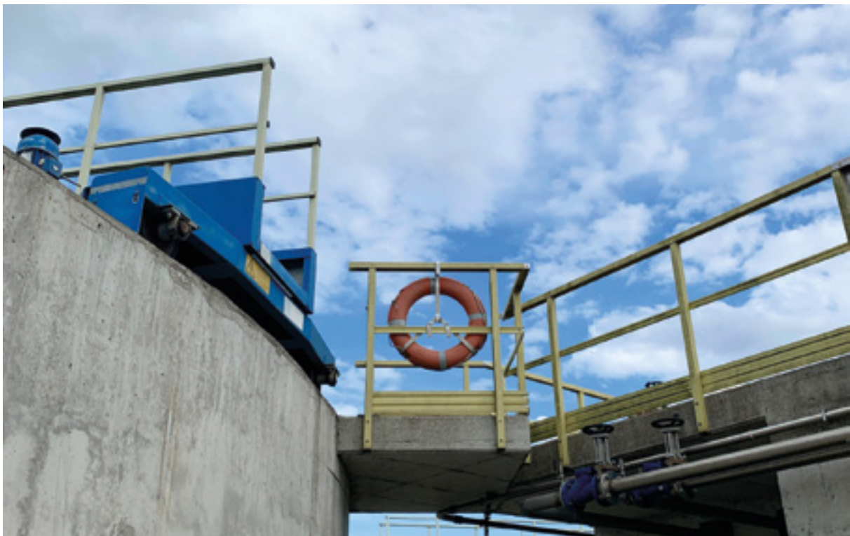
Impianto di depurazione - dettaglio.
