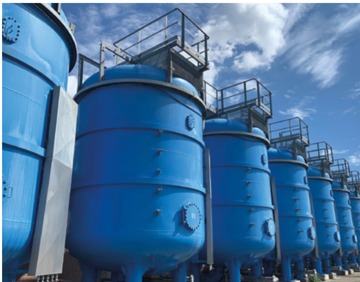
Filtri a carbone, Centrale di potabilizzazione di Serravalle.
