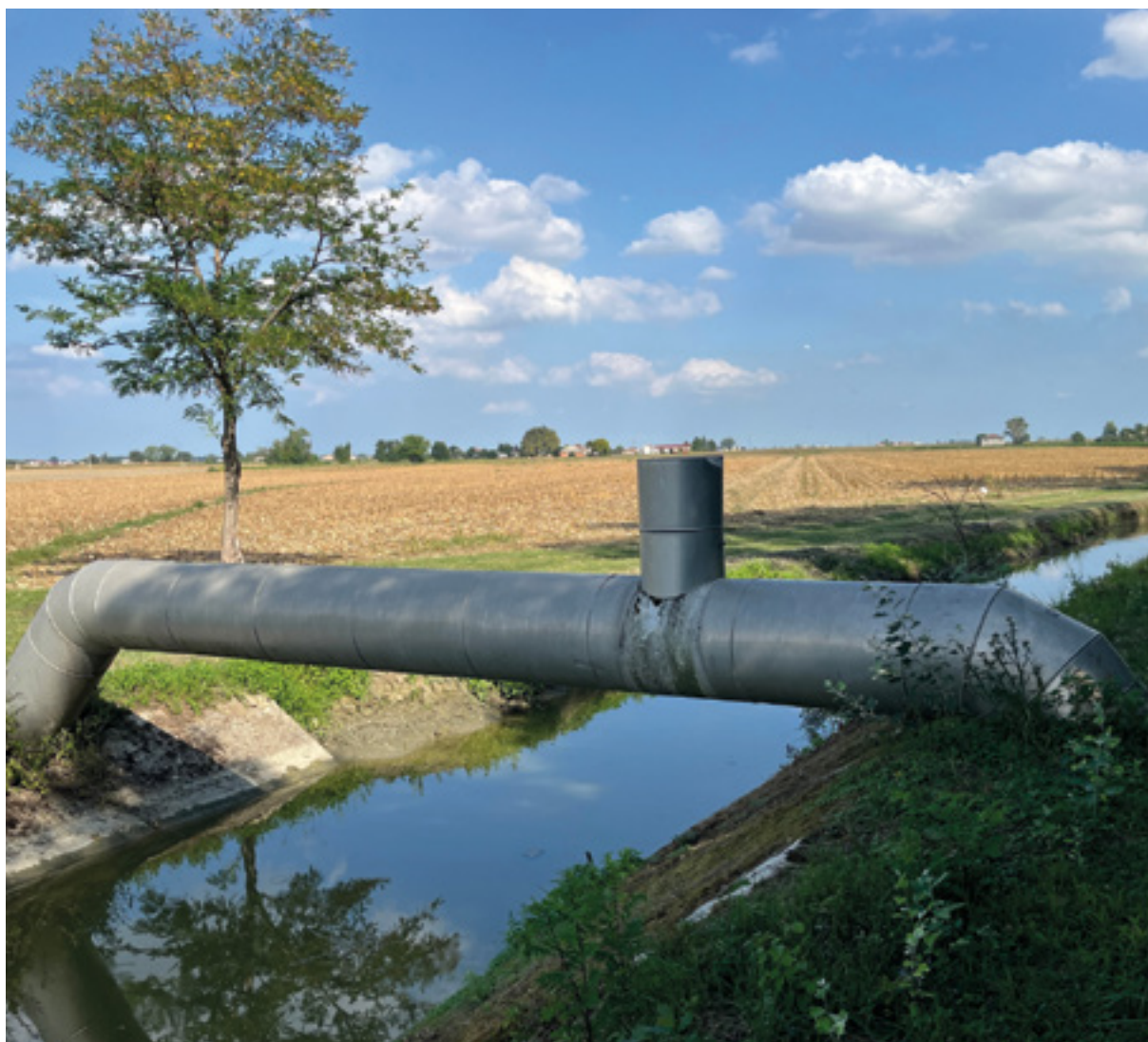
Collegamento tra pozzo e Centrale di potabilizzazione di Ro.
