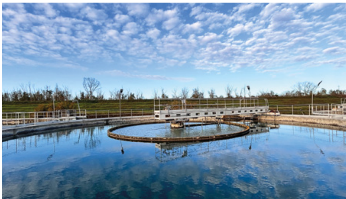
Vasche di chiarificazione - Centrale di potabilizzazione di Serravalle.
